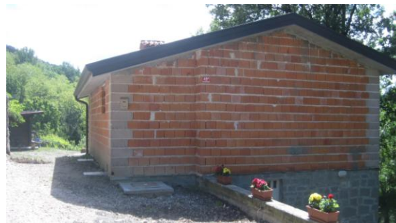
Slika 7 Obstoječi RJ za hišni vodomer ob stanovanjski hiši 45A
