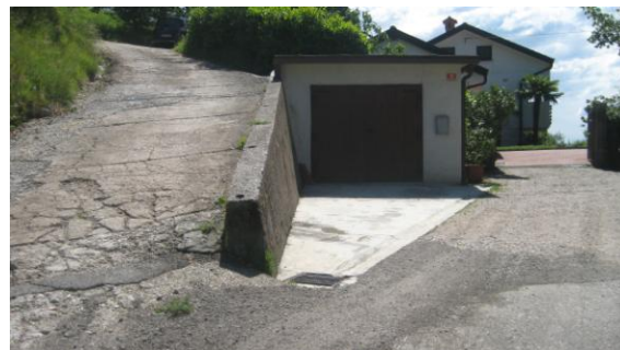
Slika 3: Betonsko vozišče na lokaciji črpališča Bonetovšče II.
